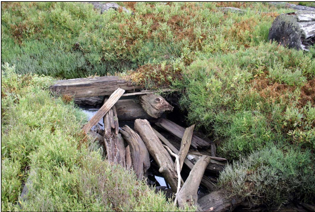
Figure 15. Débris et billots empêchant l'écoulement des eaux de marée.
