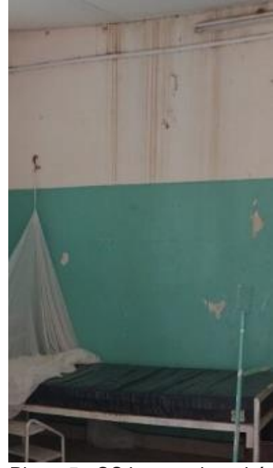
Photo 5 : CS Logo sabouciré toiture qui coule
