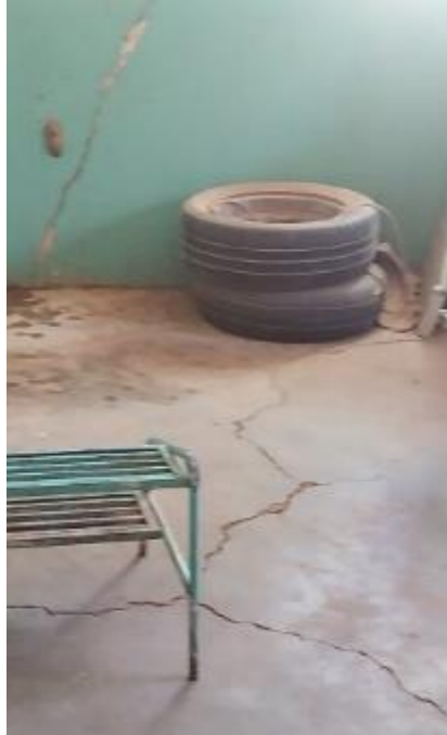
Photo 4 : CS Logo sabouciré Fissures dans le mur et le plancher de la salle de soins
