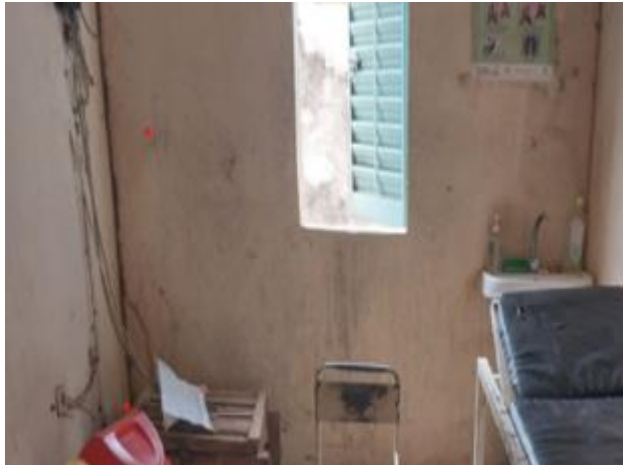
Photo 1 : CS Baladougou Mur de la salle de soins dégradé avec galerie tunnel de termite
