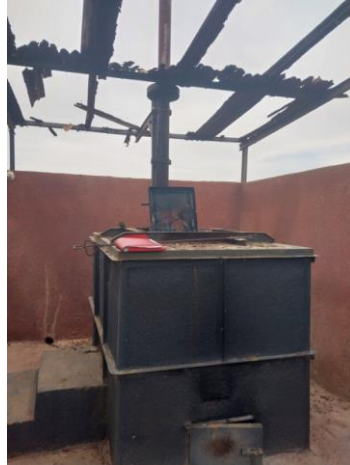
Photo 24 : Incinérateur dégradé encore utilisé CS Baladougou
