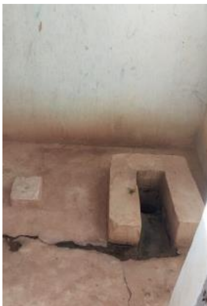
Photo 7 CS Badinko Latrine VIP double fosse avec la dalle fissurée
