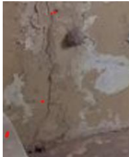
Photo 2 CS Kobefa; fissure dans le mur de la salle d'accouchement
