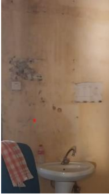
Photo 3 : CS Logo sabouciré Infiltration d'eau dans le mur de la salle de consultation
