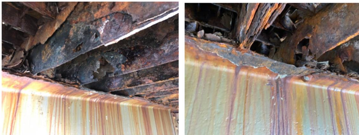
Figure 10-3: État des caillebotis sous la promenade
