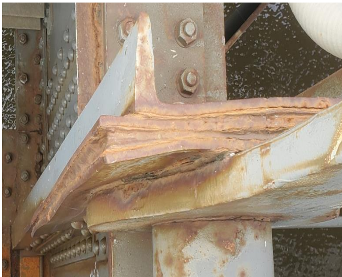
Figure 10-15: Soulèvement par la rouille – l'accumulation de matériau de corrosion entre les membres
