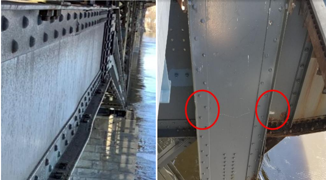
Figure 10-13: Déformation en raison du flambage
