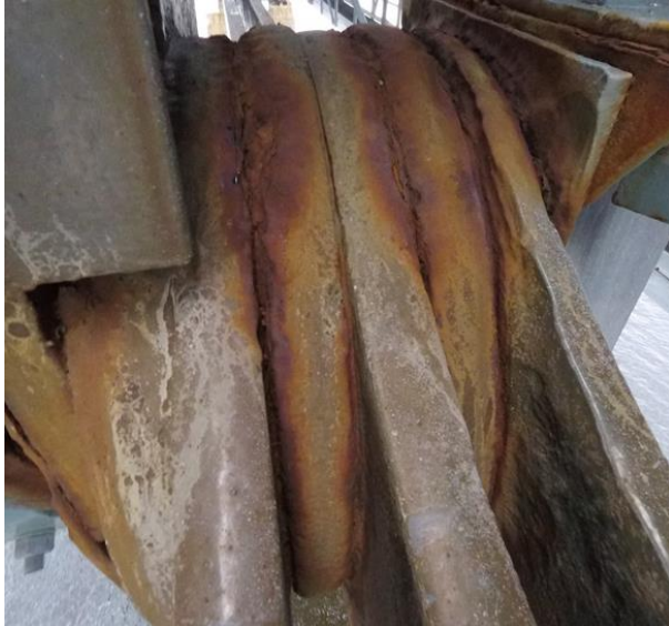
Figure 10-14: Assemblage des barres à œil montrant la corrosion
