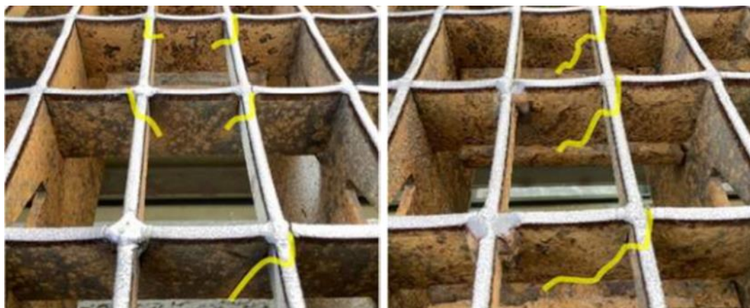
Figure 10-5: Fissures dans les caillebotis de la voie est qui nécessitent une réparation
