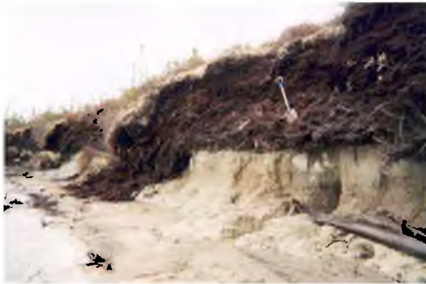
Photo 13-2 : Lac Sakami – Talus instable composé de sédiments fins silto-argileux couverts d'environ 2,5 m de tourbe – Rive est, PK 84
